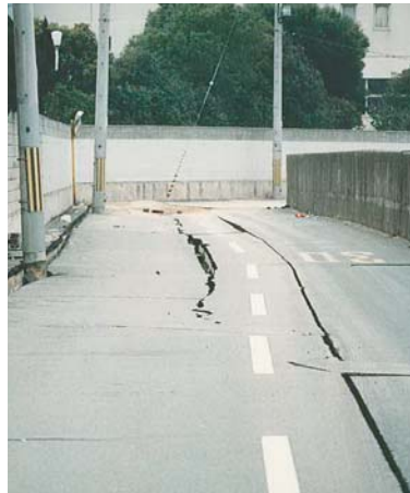
道路上の地割れ (No. 119)
