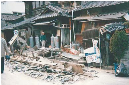
軒先に積まれた瓦礫 (No. 140)
